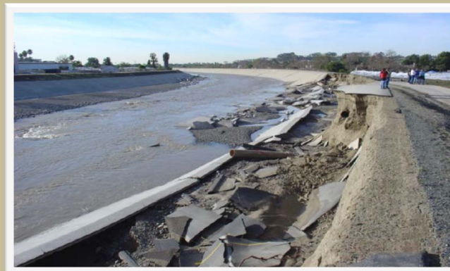
Giòng suối San Juan Creek - Sự thiệt hại bởi trận bão năm 2005 Nguồn tin: Quận Hạt Orange
