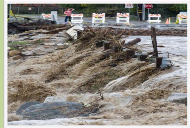
Arroyo Trabuco sobre Trabuco Canyon Road- Daños por las tormentas del 2010 Fuente: OC Register
